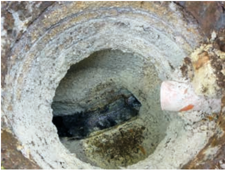
Schadensbild mit biogener Schwefelsäurekorrosion
