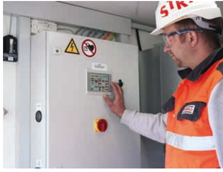
Eingabe der Lagen und Schachtnummer über Touch-Screen in der KS-ASS-Anlage
